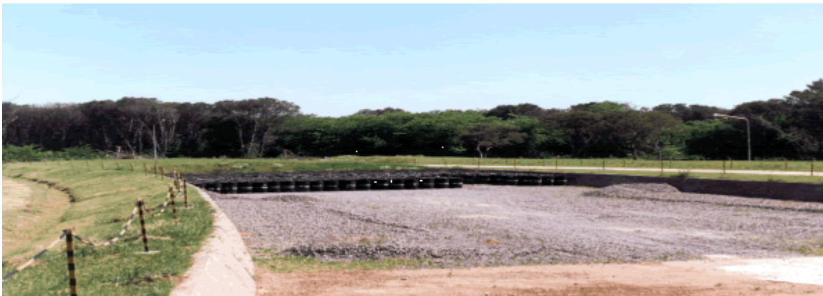
Sistema de semicontención para la disposición de residuos radiactivos sólidos de baja actividad.
