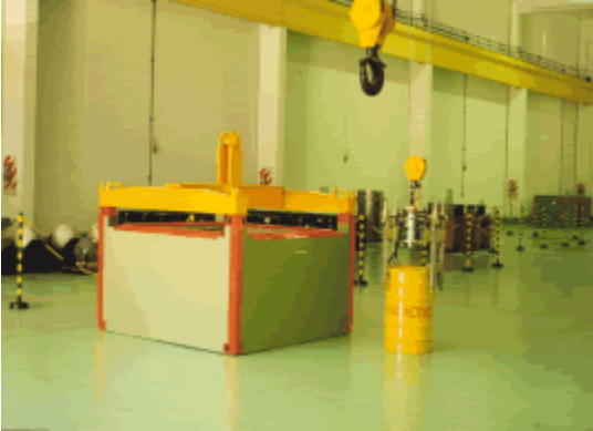
Instalación para el almacenamiento interino de bultos de residuos radiactivos
